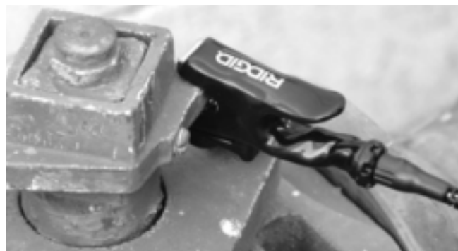
Рис. 8 – подсоединение провода кабеля к целевому проводнику
